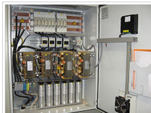
Rifasatore - Apparato per la correzione automatica dello sfasamento
